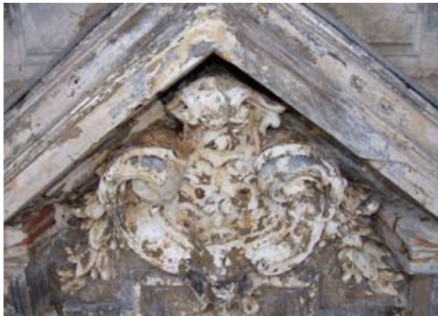
Spatzennest hinter Stuckelement vor der Sanierung
