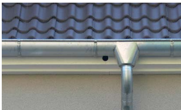
Dachkästen mit Einflugloch
