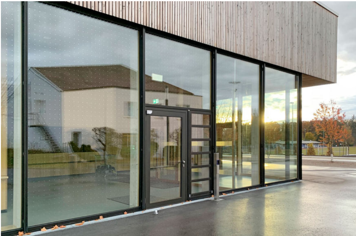
Dieses Raster aus 9 mm starken metallischen Punkten in 90 mm Abstand ist im Inneren einer Isolierglasscheibe einlaminiert und dennoch hoch wirksam. Schwarze Markierungen konnten wegen Spiegelungen bisher nur auf der Aussenseite der Fassadengläser reüssieren.
