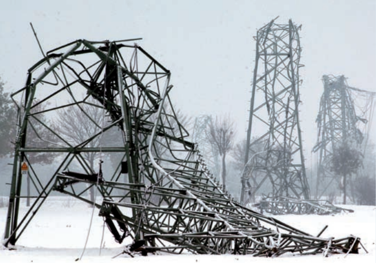
Zerstörte Strommasten im Münsterland im November 2005
