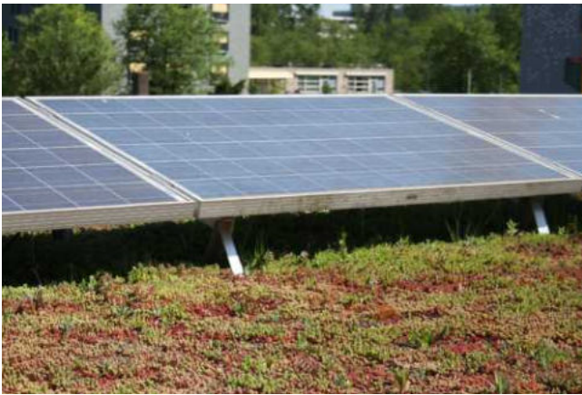
Abbildung 74: Konflikte mit Photovoltaikanlagen lassen sich inzwischen gut lösen (Foto: ZSK TP1)
