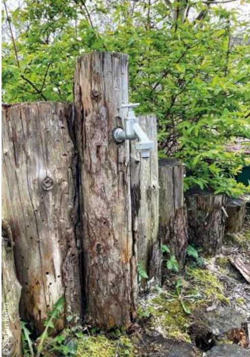
Der Wasserhahn einer Zisterne lässt sich gut in den natürlichen Garten integrieren.
