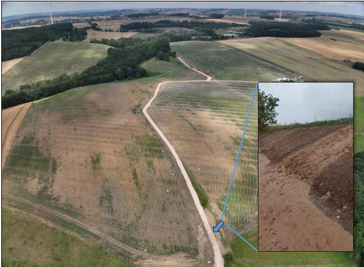
Abbildung 6 Bodenerosion in der Bauphase einer ca. 23 ha großen PV-FFA im hügeligen Unteren Westerzgebirge in Folge nicht ausreichender Vorbegrünung der ehemaligen Ackerfläche (Quelle: Ingenieurbüro Feldwisch)
