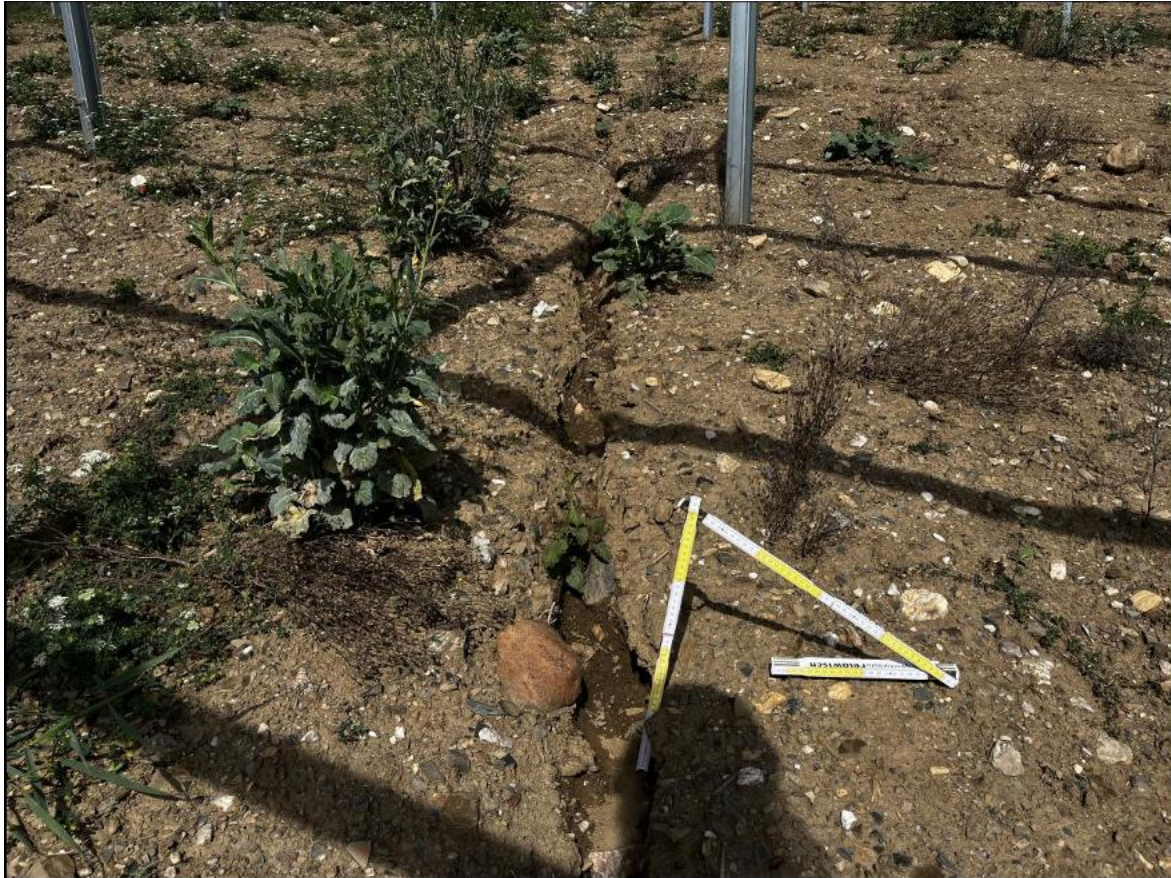
Abbildung 5 Abfluss- und Erosionsschäden auf einer PV-FFA, die zu Baubeginn nicht ausreichend begrünt war (Quelle: Ingenieurbüro Feldwisch).
