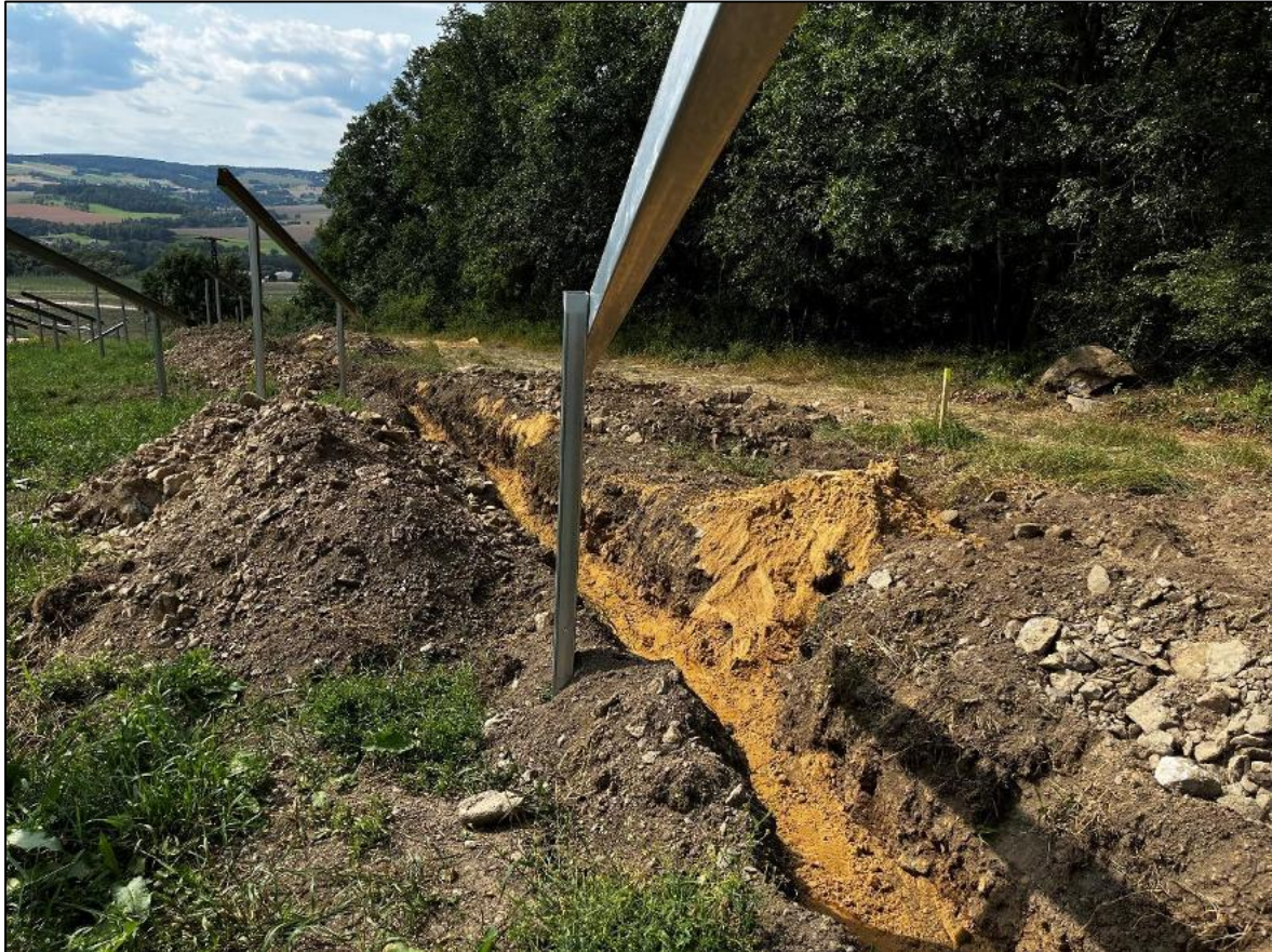
Abbildung 4 Substratvermischungen durch fehlende Trennung des Ober- und Unterbodens und des Bettungsmaterials (Quelle: Ingenieurbüro Feldwisch).
