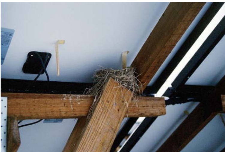
Abbildung 22: Vogelnest im Holzgerüst auf der Rückseite eines Moduls in Hemau
